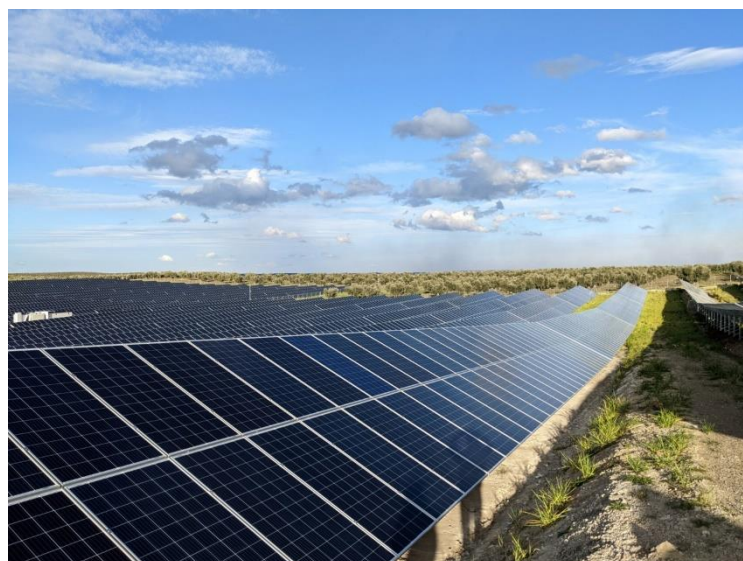
PV El Toconal (Toledo) 5 MWp
