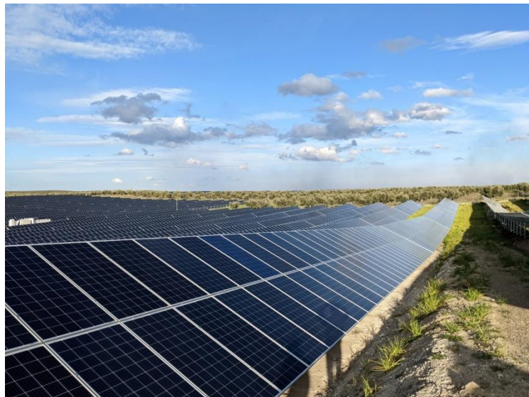
PV El Toconal (Toledo) 5 MWp
