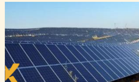
PV La Zarzuela (Toledo) 20 MWp
