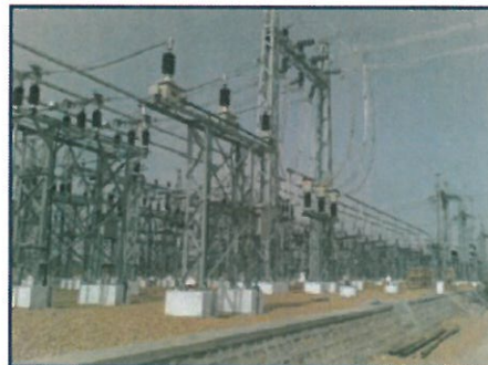
Subestación proyecto Bhakrani-Rajasthan
