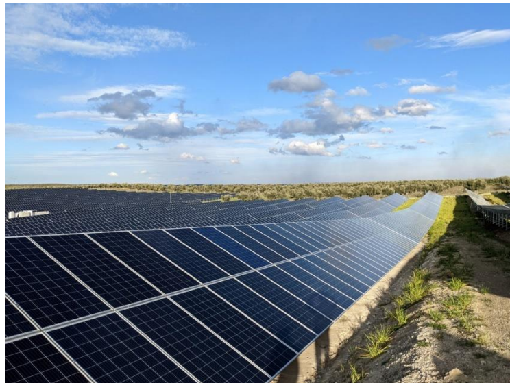
PV El Toconal (Toledo) 5 MWp
