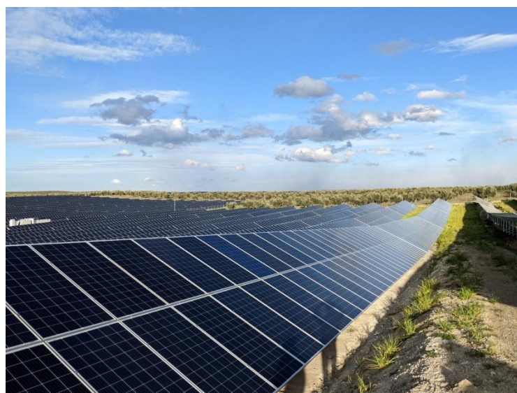
PV El Toconal (Toledo) 5 MWp
