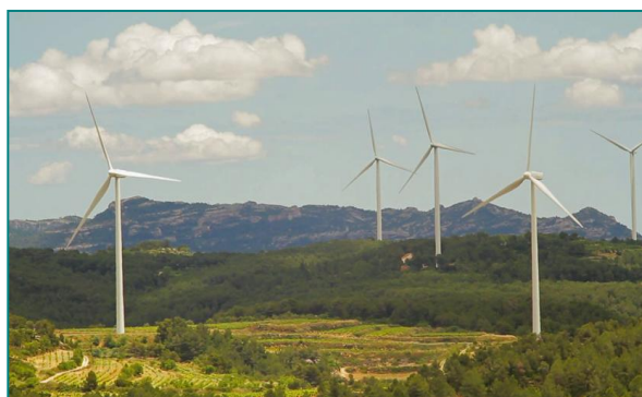
The Hinojal Wind Farm
