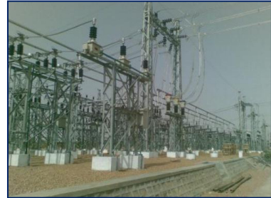
Subestación proyecto Bhakrani-Rajasthan
